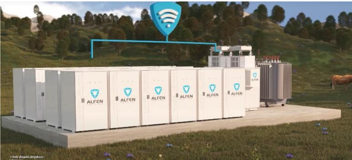
Kuva 73. Viitteellinen kuva sähkövarastoalueen moduulista (Lähde: Alfen).
