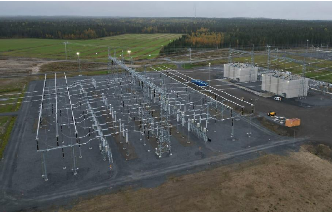
Kuva 14. Fingrid 400 kV duplex kytkinlaitos (Lähde: VEO Oy).
